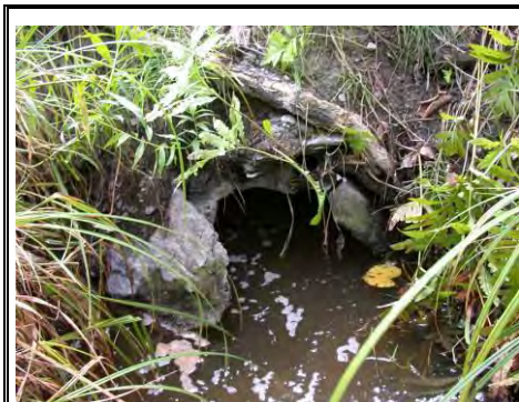
Pt 2: Ponceau endommagé
