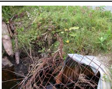
Pt 1: Érosion et grillage côté amont
