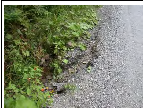
Pt 2: Ravinement le long de la route
