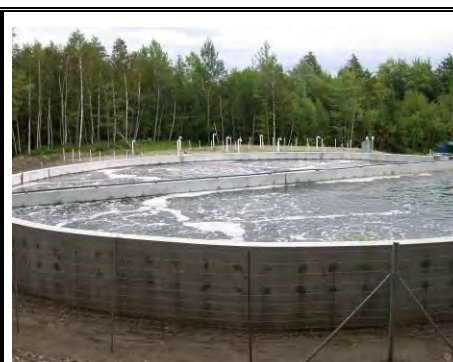
Pt 12: Bassin d'aération des eaux usées
